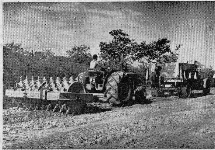
Tanque regando agua, para obtener humedad óptima y rodillo pata de cabra compactando la sub-base
